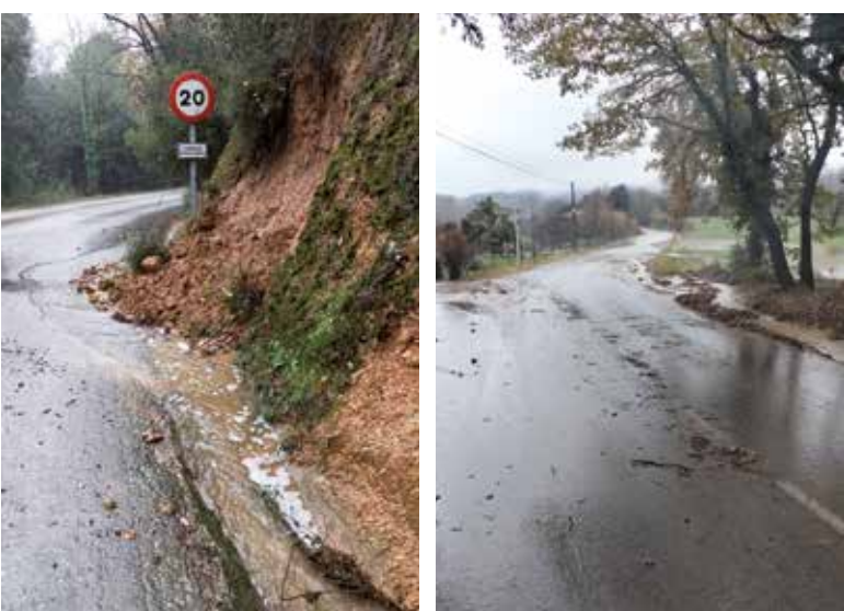
A Sant Julià, l'aiguat va provocar algunes esllavissades de terra a la carretera que va al carrer Vell i a l'altura de Can Garriga l'aigua va negar la calçada i la va deixar plena de fang i restes vegetals.
